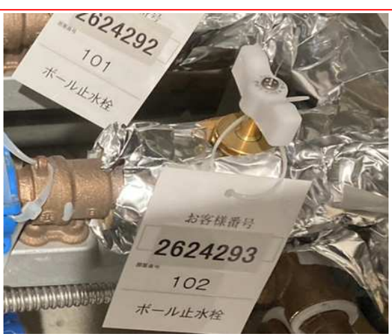
止水栓(赤)のレバーが管に対して 垂直の状態が閉っています。
