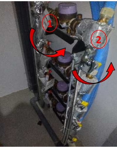
①(赤)を閉めてから②(黄)を開けま す。①②の順で操作してください。 水を出し終わったらを閉めて下さい。
